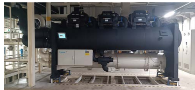
STTに設置されたチラーシステム
