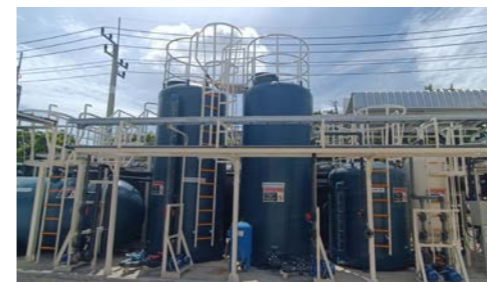
STTの敷地内に設置された排水処理プラント
