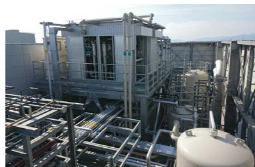
熊本テックの燃焼除害用水の排水回収設備
