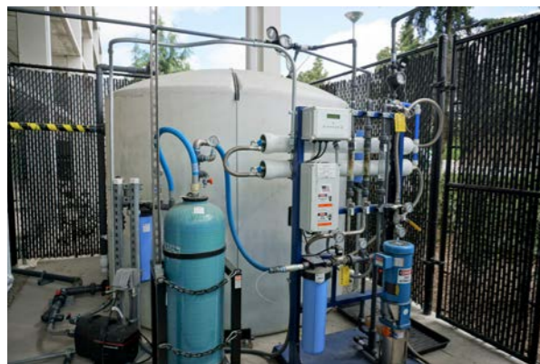
Sony Electronics Inc.のサンディエゴオフィスの敷地内に設置された地下水処理設備
