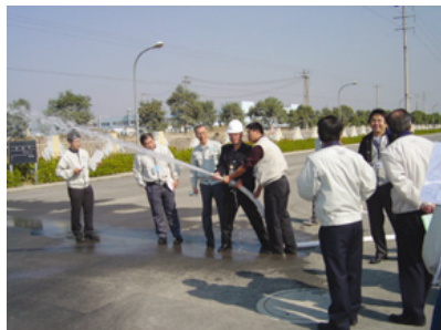
索尼電子(無錫)有限公司(中国)での屋外消火栓の放水テスト
